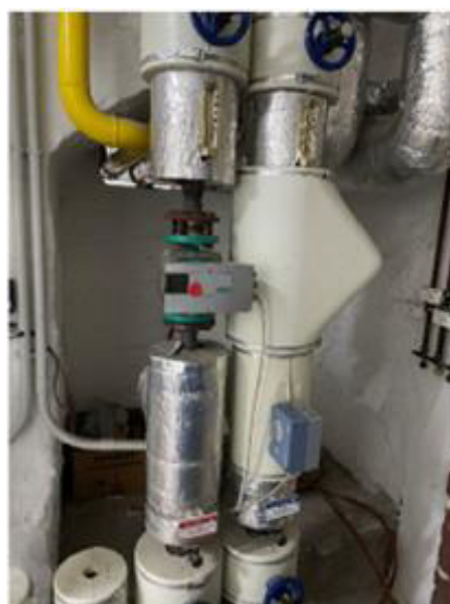
Abbildung 16: Fehlende Armaturendämmung in einer Kirche
