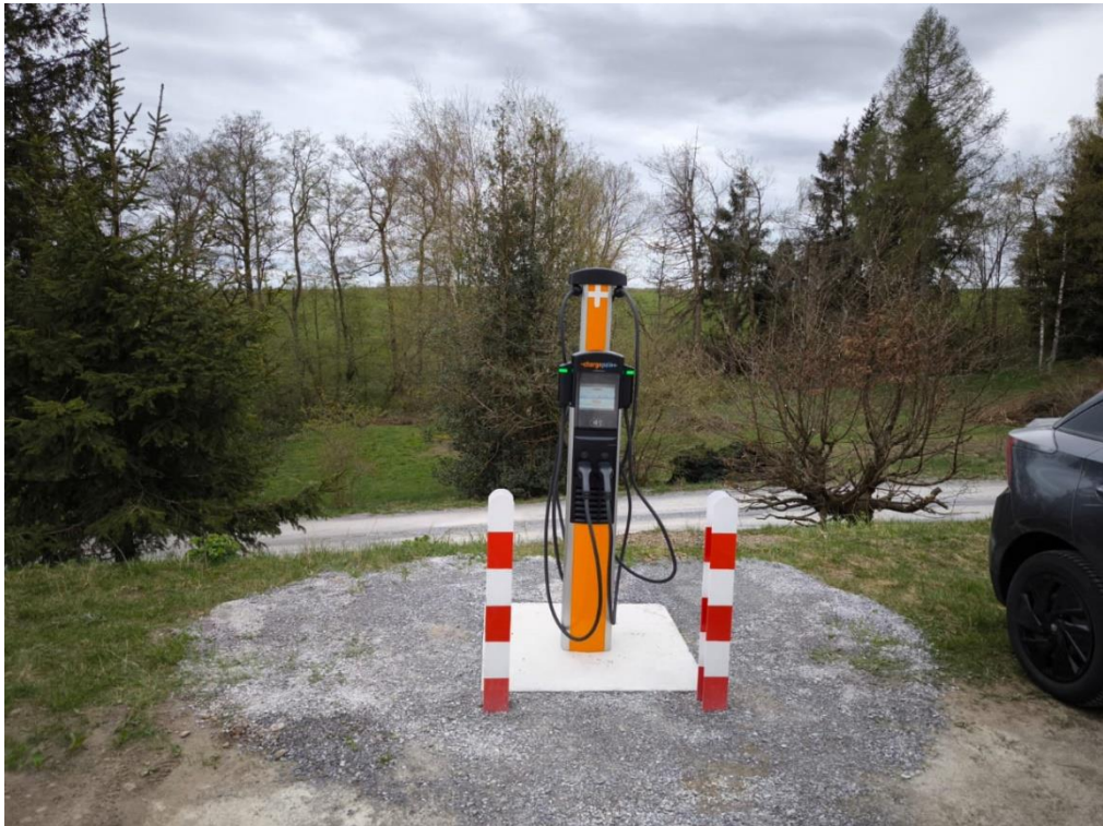
Ladesäule Königshütte „Ausbau der flächendeckenden Ladeinfrastruktur“
