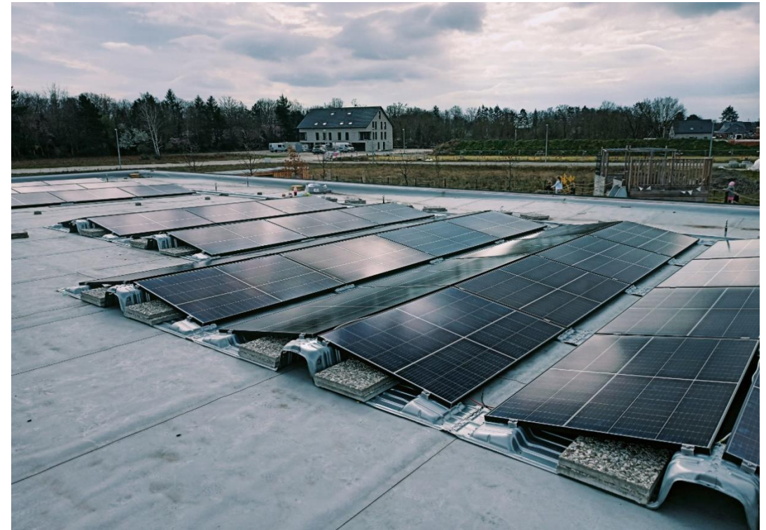
PV-Anlage KiTa Wilscher Weg
